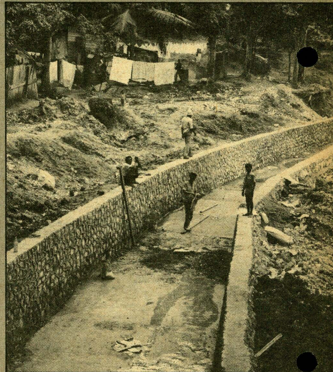
Die Bauarbeiter sind stolz, an diesem Projekt der Manley-Regierung mitzuarbeiten. Es ist ein Müll- und Abwasserkanal, der dazu beitragen soll, die menschenunwürdigen Zustände in den Slums zu verbessern.
