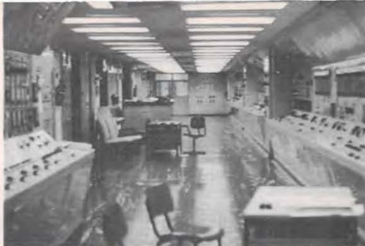
Kontrollraum in Dimona, dem Herzstück des israelischen Atomprogramms.
